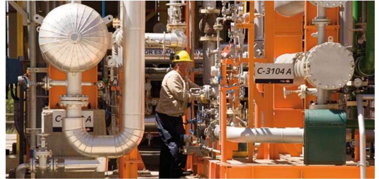
La Plata refinery (Argentina).
