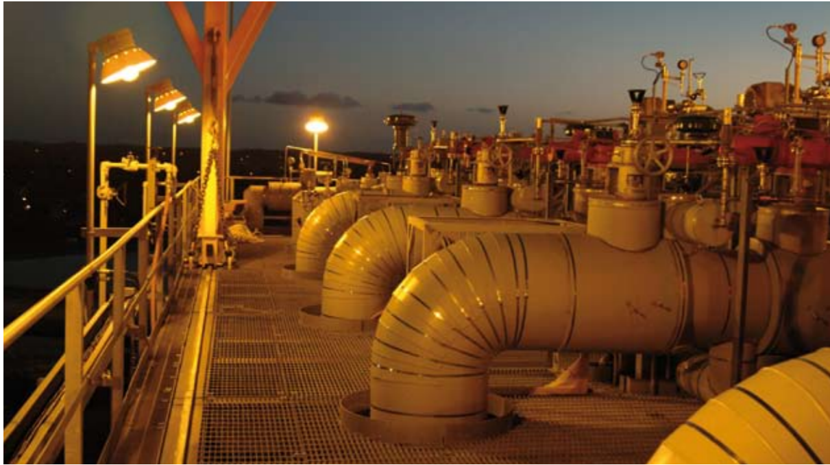
Instalaciones de GNL de Repsol en Trinidad y Tobago.
