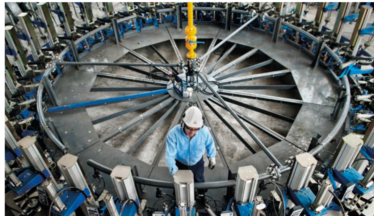
Planta de GLP en Perú, donde Repsol tiene una cuota de mercado del 29%
