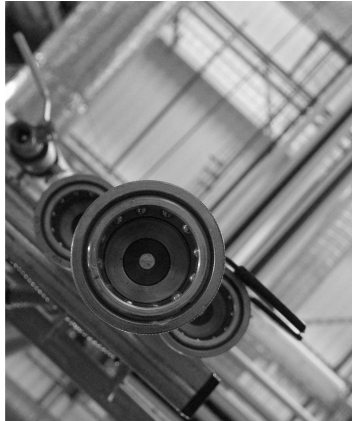
Conductos de gas destinados a la investigación en el Centro de Tecnología de Repsol, situado en Móstoles (España).
