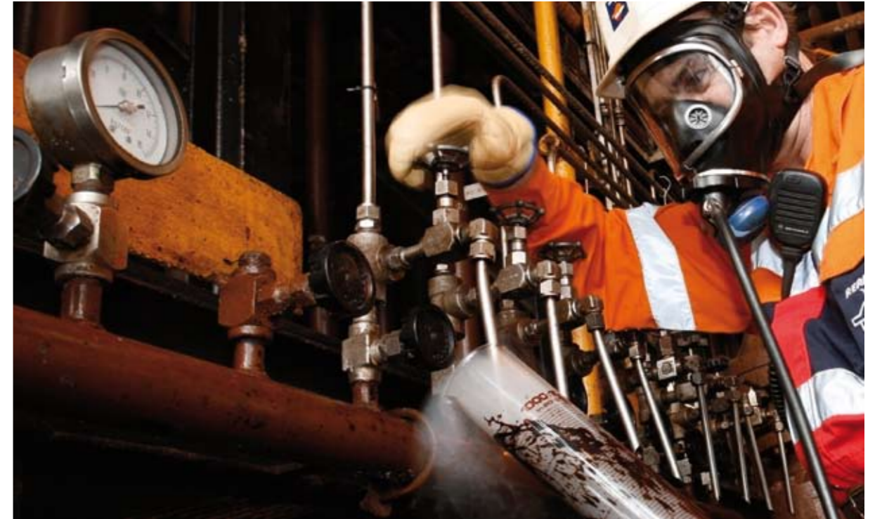
Operario de Repsol en Casablanca, la única plataforma de extracción de petróleo de España.
