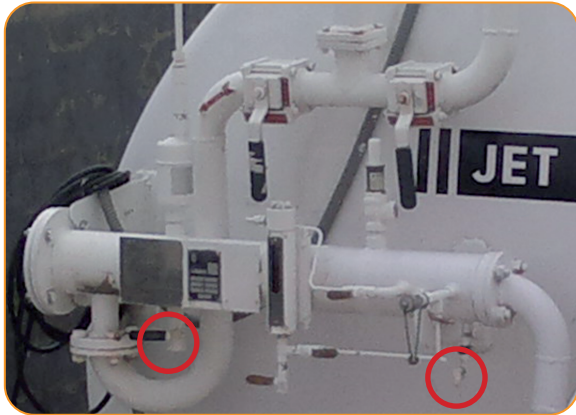
Purga de filtro
