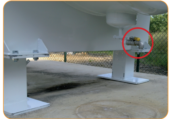
Purga de tanque
