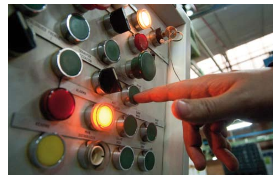
Panel de control en el complejo industrial de Puertollano (España).
